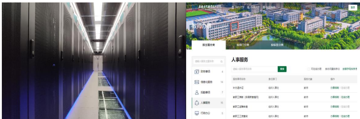
图 3-12 学校数据中心机房与“一网通办”服务平台
